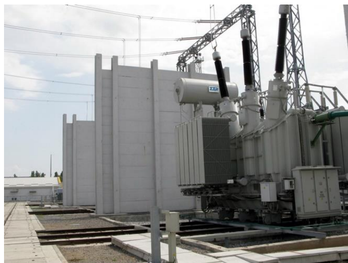
Рис. 3. Силовий трансформатор підприємства Дніпросталь
