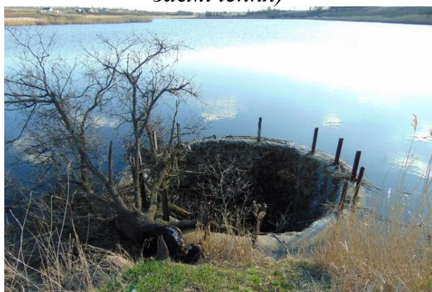
вхідна частина водоскидної споруди (фрагменти руйнування та засмічення)
